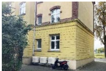
Abb. 42: Installierte Außeneinheiten an Demonstrationsgebäuden
