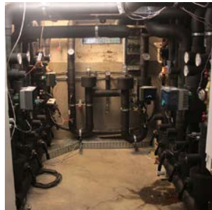
Abb. 53: Hydraulik der Quell-Erdschließung im Keller
