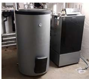
Abb. 37: Speicher und Wärmepumpengerät
