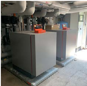
Abb. 52: Wärmepumpen im Keller
