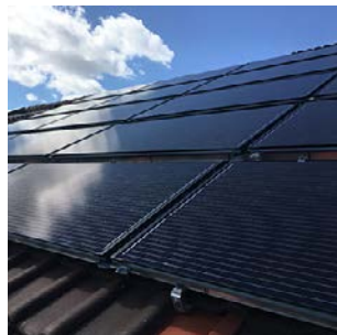
Abb. 58: PVT-Kollektoren auf dem Dach des Gebäudes
