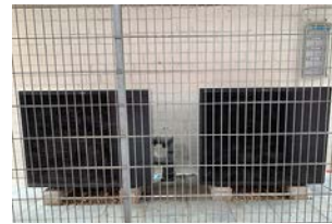
Abb. 67: Zwei Außeneinheiten der Wärmepumpe
